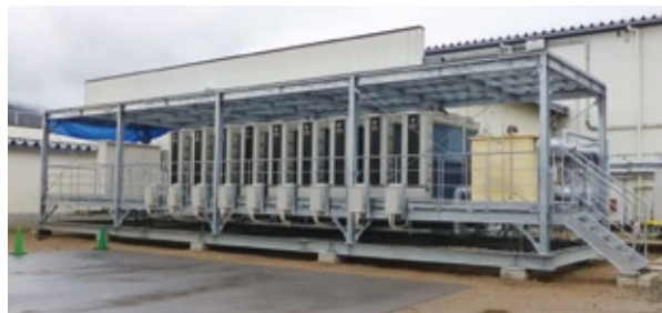
田辺製薬吉城工場に2012年度新設の電気式冷水チラー
