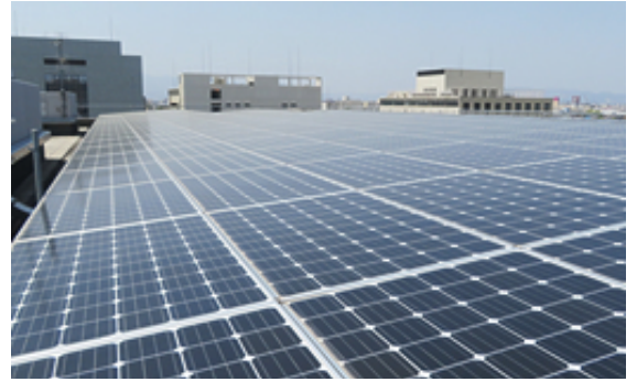
加島事業所オフィス棟屋上の太陽光パネル
