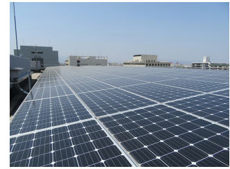
加島事業所オフィス棟屋上の太陽光パネル
