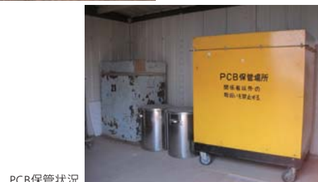
PCB保管状況
