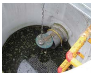
新たに設置した緊急遮断弁
