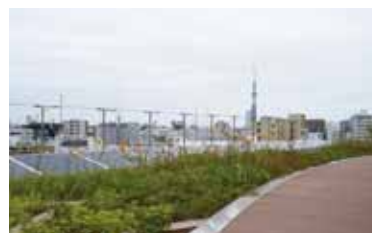
屋上の太陽光パネル
