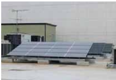
屋上の太陽光発電パネル パネル設置数48枚(最大10.08kW) 発電量約12千kWh/年 CO 2 排出量削減効果約4トン/年
