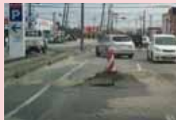
液状化で飛び出したマンホール（鹿島工場周辺）
